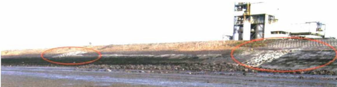
Dijkvak met verzwakte en deels gerepareerde stukken bij Arkema
