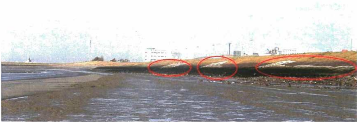
Dijkvak met verzwakte en deels gerepareerde stukken
